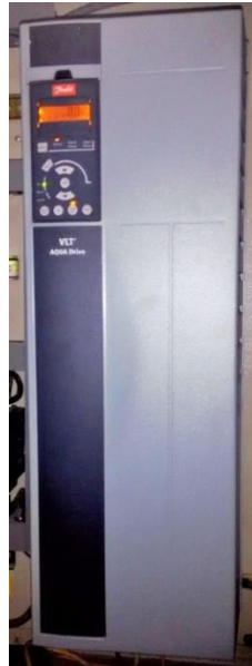
Figura 6. Variador de frecuencia Danfoss de 60 Hz
