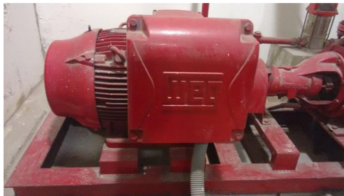
Figura 5. Motor de corriente alterna marca WED de 30 HP
