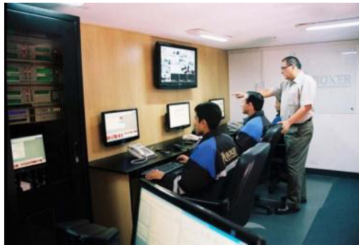
Figura N° 04: Central de monitoreo
