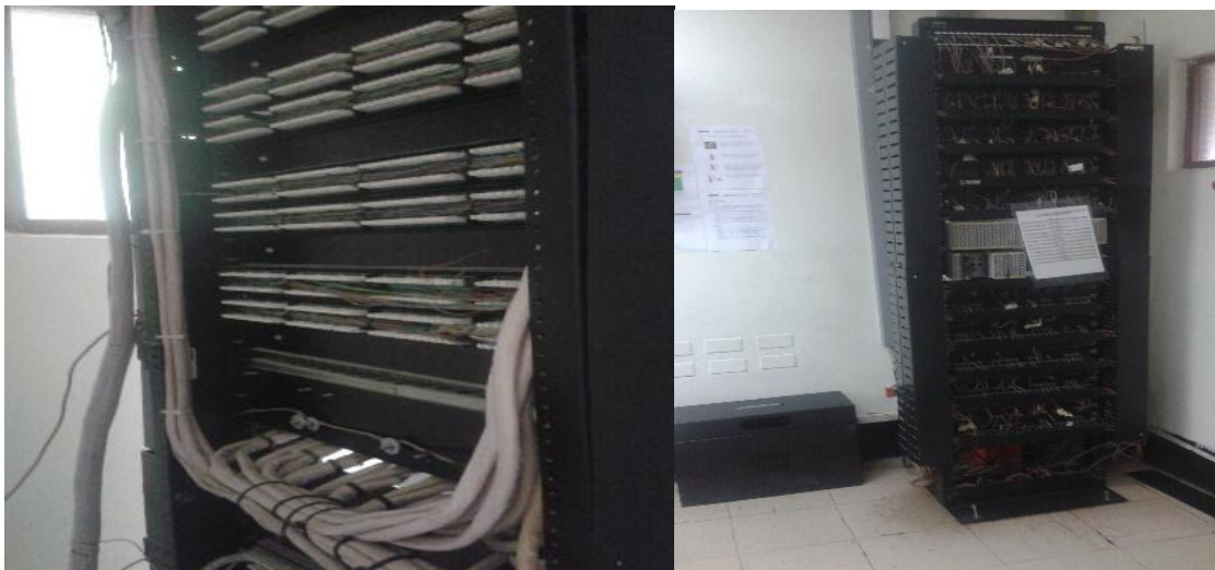
Figura: N° 15: se observa parte frontal, trasera y las conexiones del gabinete.
