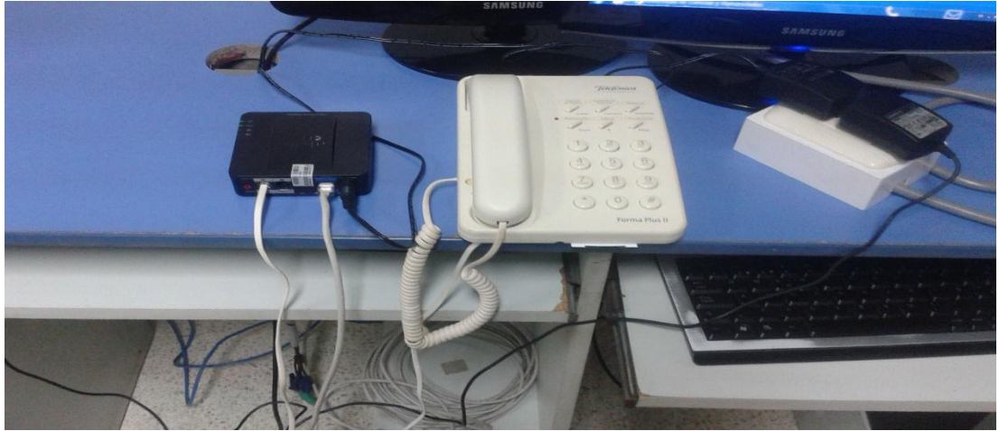
Figura N°2: en la figura se puede observar la conexión del adaptador ATA SPA 112 conectado al teléfono analógico en este caso el anexo 22 y su respectiva conexión a la red.
