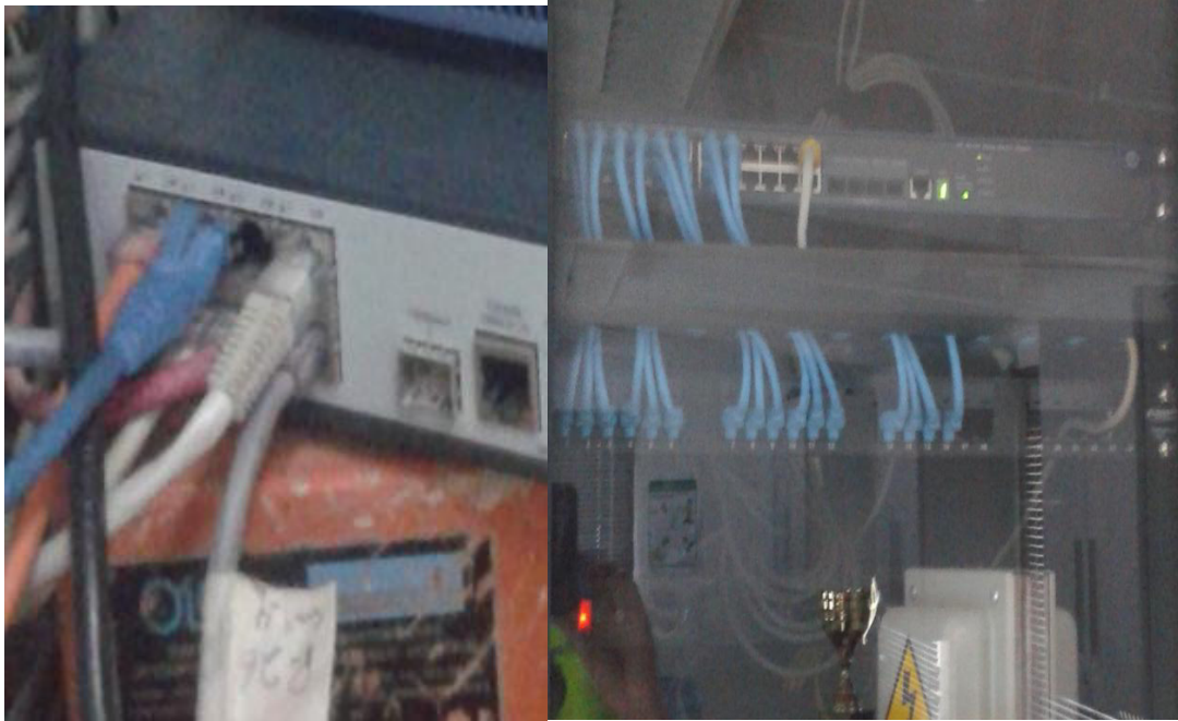
Figura: N° 14: se puede observar la llegada de señal de cable de red al Switch HP A5120 y la salida a los gabinetes.
