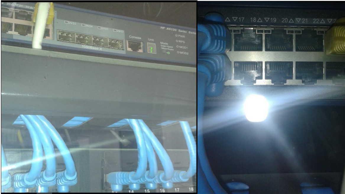
Figura: N° 19: se observa la parte frontal del switch donde se va a conectar los equipos a la red.
