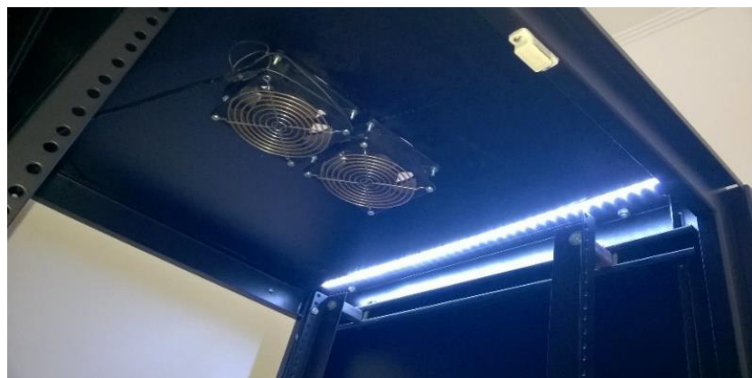
Figura 9. Cooler de refrigeración
