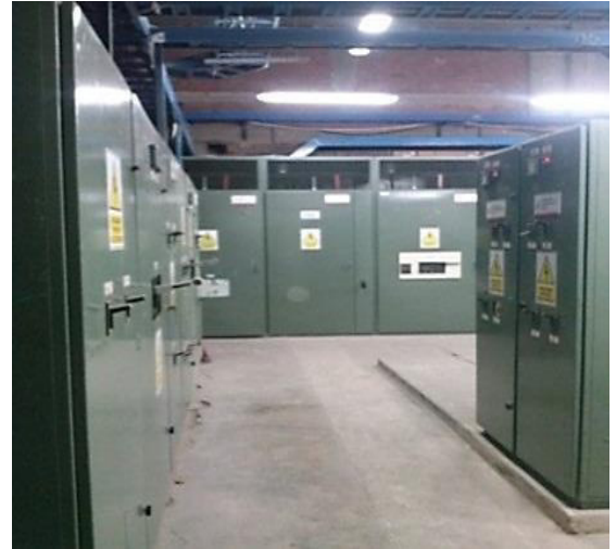
Figura 9: Tablero planta inyección primer nivel Fuente: cortesía SMI PET S.A.
