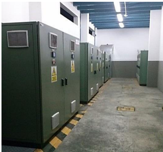
Figura 10: Tablero planta soplado Fuente: cortesía SMI PET S.A
