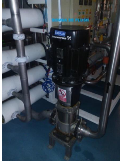
Figura 13. Bomba de alta presión.
