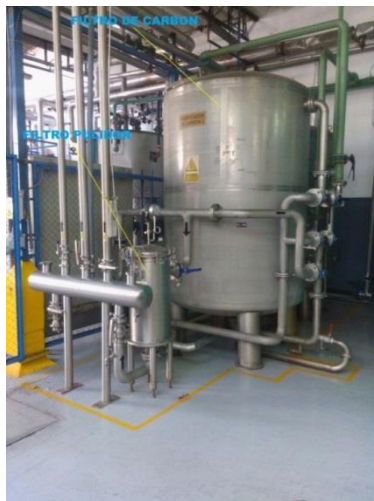
Figura 10. Filtro de carbón activado.
