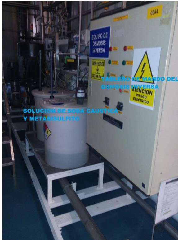
Figura 18. Tablero de fuerza del equipo ósmosis inversa.
