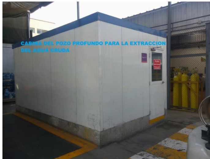
Figura 8. Cabina de extracción de agua cruda
